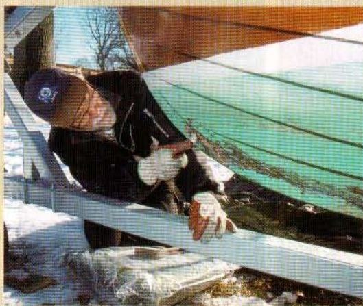
Skarven, spunningen, där kölplanken möter stävplankan, är ett väldigt känsligt ställe. Skrapa bort färgen och inspektera noga.
